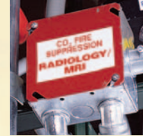
Cajas de conexión
