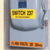
Identificación de Paneles y Switch
